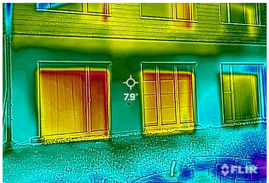
Eine Thermografiekamera macht schwach gedämmte Bauteile (rot und gelb) sichtbar.
