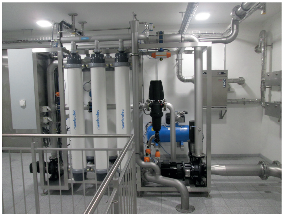
Filteranlage mit modernster Membrantechnik
